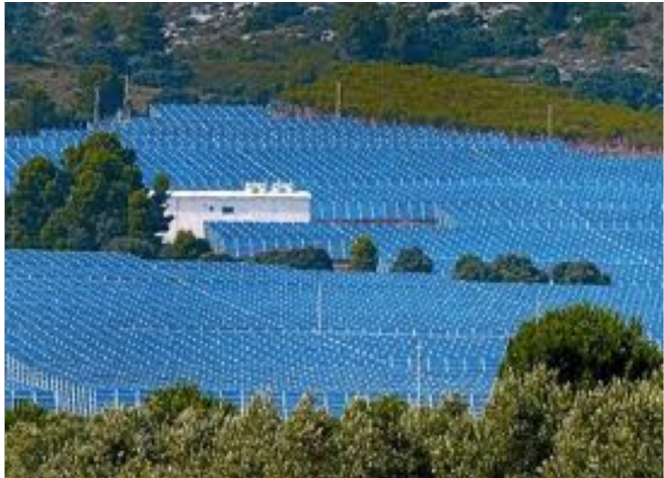
Central fotovoltaica de Beneixama
